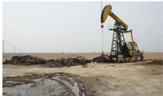
图为7592井口直角弯处理现场及7592至7591井 线路破损远摄
